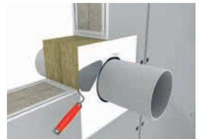
Verschließen des Ringspalts und beschichten der Würth Mineralfaserplatte AB mit Würth Brandschutzbeschichtung AB (Beschichtung/Füller/Hybrid)
